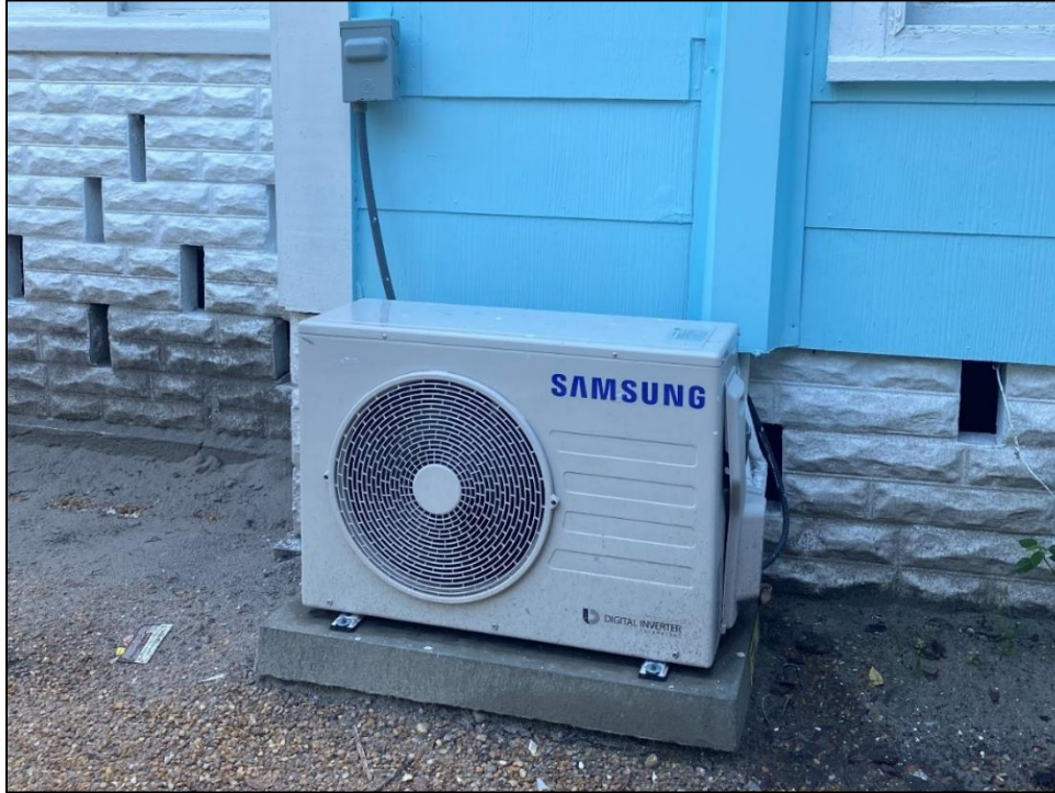
Figure 15: Mini split condenser unit
